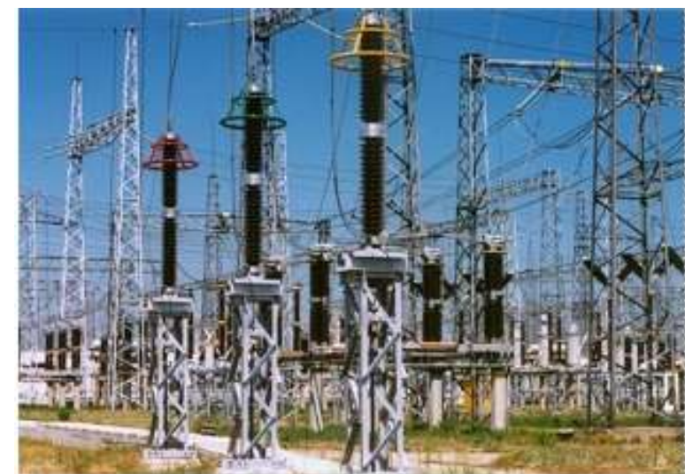
图 5 某 500KV 枢纽变电站
