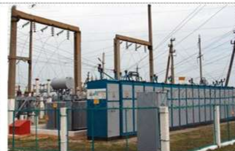
图 8 某 35KV 终端变电站
