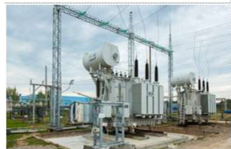
图 7 某 110KV 地区变电站
