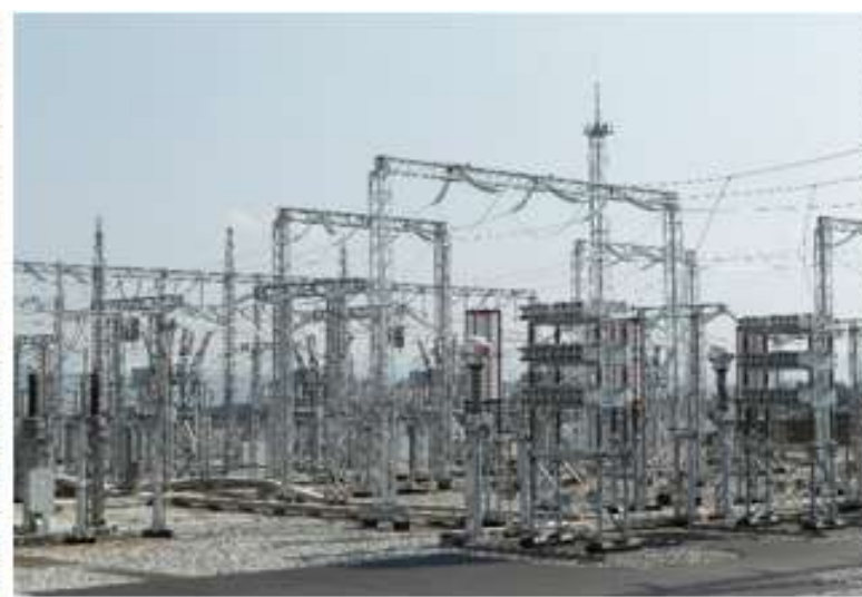
图 6 某 220KV 中间变电站
